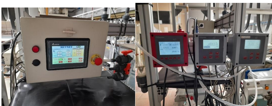
Fotografía nº 6.- Vista general de sistemas de controladores de condiciones, pH, rH, (O 3 ).
