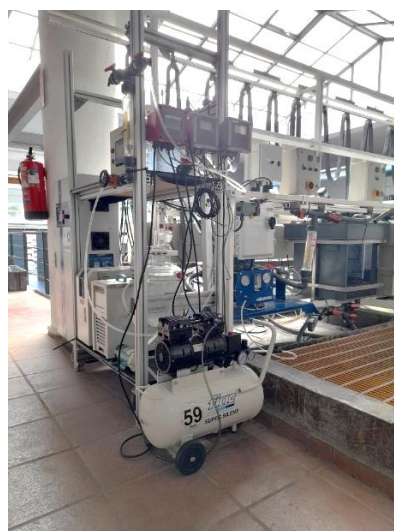
Fotografía nº 3.- Vista general de los componentes de la etapa de ozonización.
